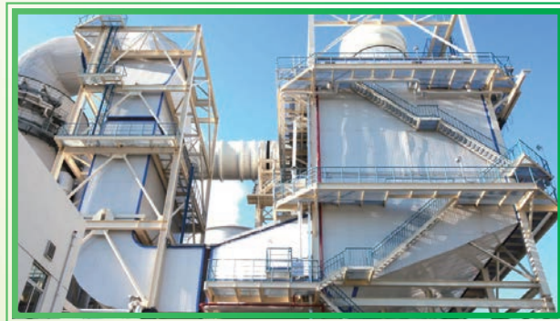
國華三河電廠「近零排放」濕式除塵器設備
